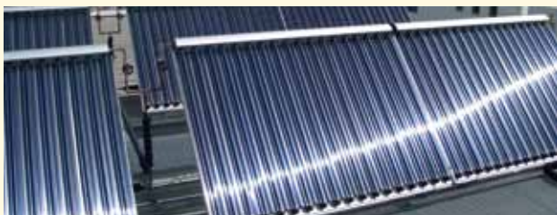
Eine LATENTO Anlage auf dem Dach des Playmobil Funparks auf Malta
